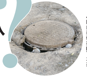
小区内已破损的下水井。
