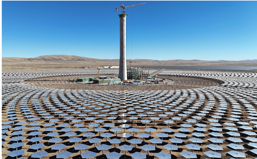
图为那曲市安多县帕那镇土若村的“100MW光热+800MW光伏”一体化项目建设现场。 西藏日报记者 赵书彬 摄
