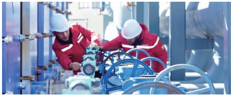
因为工作人员在检查换热站运行情况 西藏日报记者 万靖 摄
