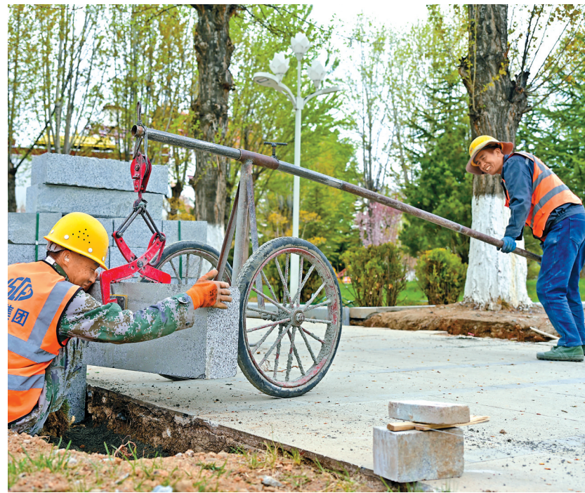
近日，布达拉宫广场部分区域悄然焕新。拉萨市政养护工人顶着烈日，对路面开展精细化修缮，对松动地砖进行调平加固，对破损石材进行同质替换，确保路面平整、无缝衔接。据悉，此次修缮采取分段施工的方式，修好一片、开放一片，最大限度减少对市民和游客的影响。
