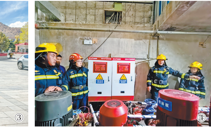
图④:消防员在设备间学习掌握消防电气控制柜操作规范,明确喷淋、消火栓系统控制逻辑,确保关键时刻设备可靠运行。
