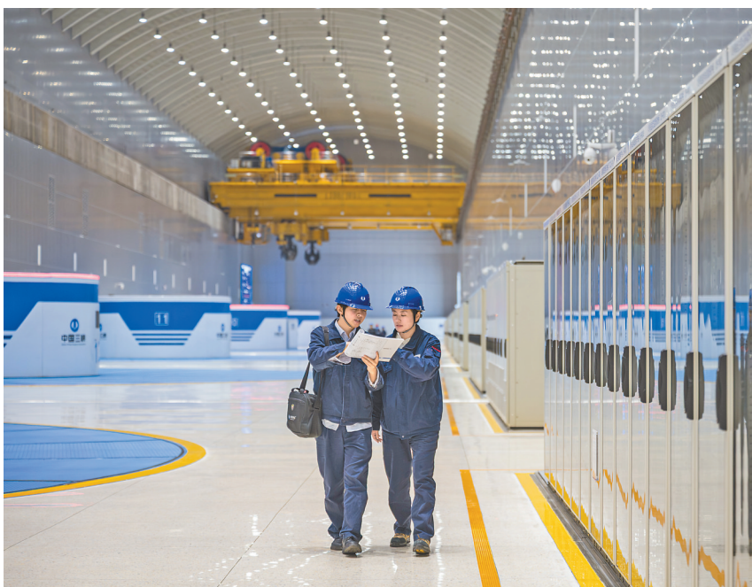
图为2025年12月19日，工作人员在白鹤滩水电站开展日常巡检工作。
