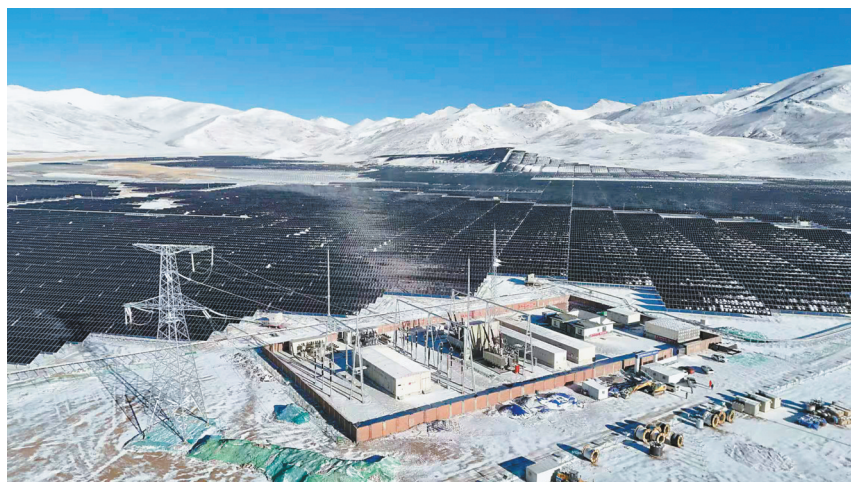
图为益青光伏项目一角。
