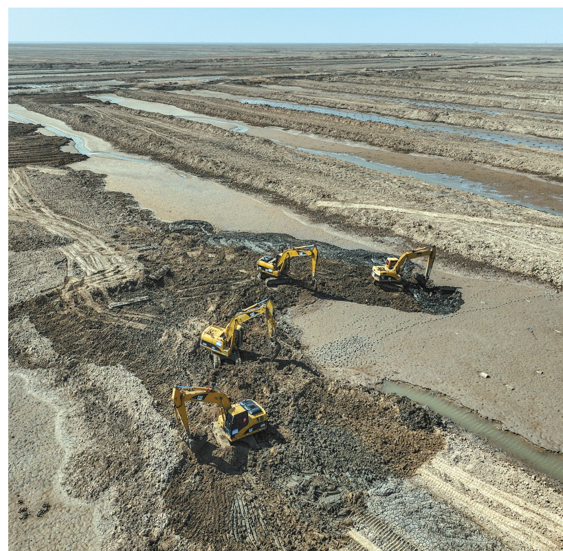
春日,在辽宁辽河口国家级自然保护区内,数台大型机械有序开展地形修复作业。这里是盘锦市海洋生态保护区修复工程项目的施工现场。
