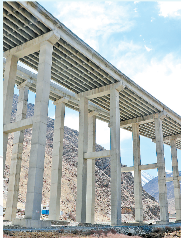
下图:西藏S5线新仓段一排排高耸的高架桥墩(2024年6月26日摄)。
