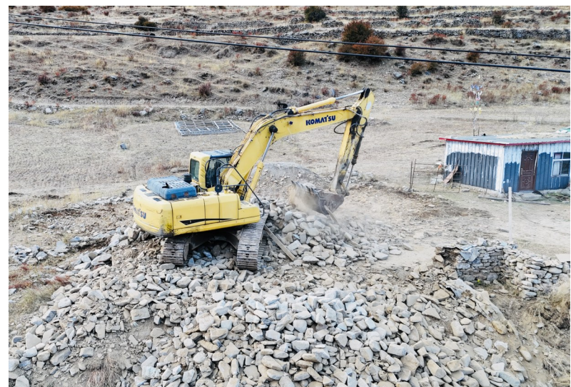
为进一步推进城乡环境综合大整治行动,连日来,林周县阿朗乡积极开展“两违”整改工作,成功拆除辖区内一处占用基本农田的违法建筑。图为拆除违法建筑现场。
