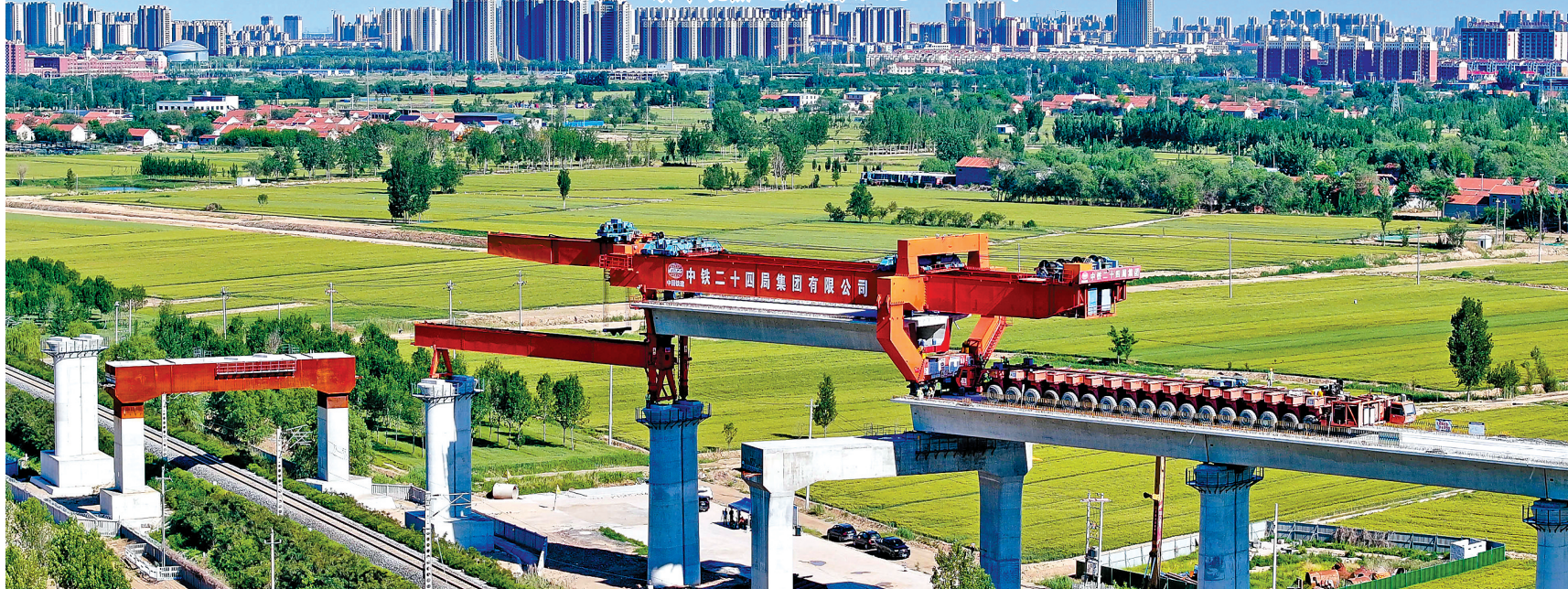
压题图片：5月15日，在(新)济(州)高铁南济2号特大桥，中铁二十四局的工作人员正在进行架梁作业(无人机照片)。
