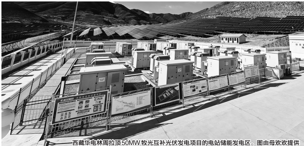
西藏华电林周拉顶50MW 牧光互补光伏发电项目的电站储能发电区。图由母欢欢提供
