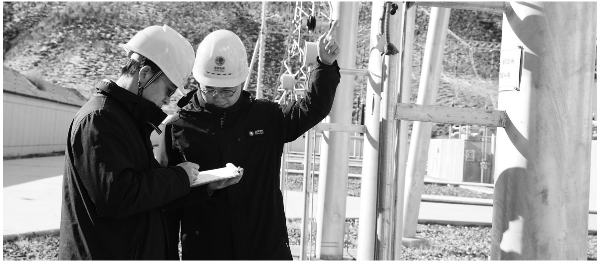
运维人员正在开展设备检查工作。图由国网西藏电力有限公司提供
