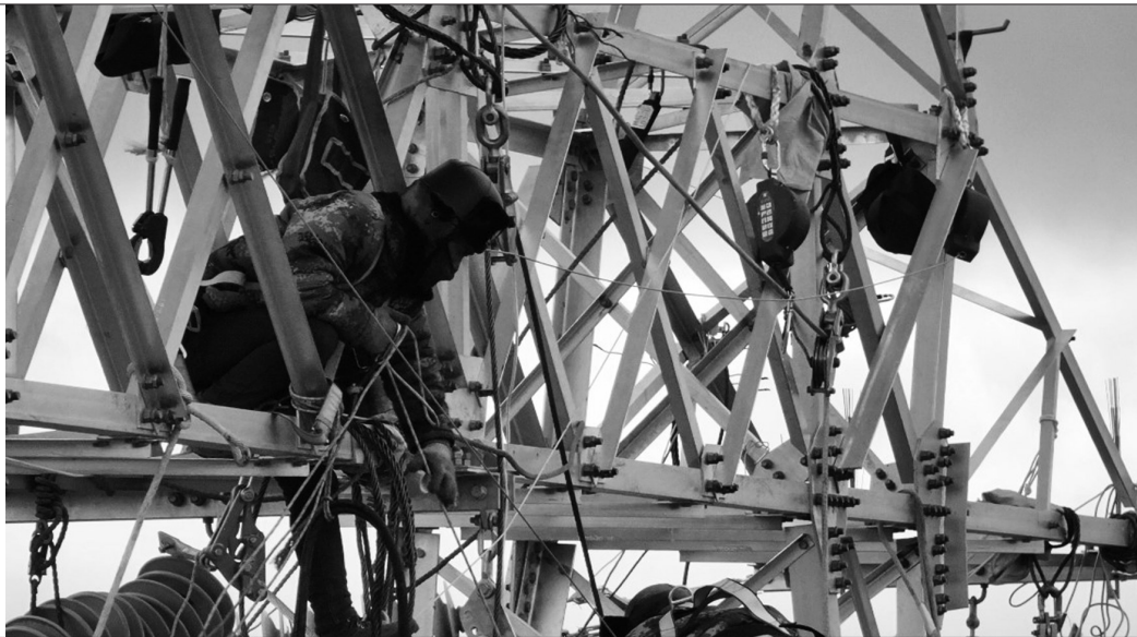
那曲市色尼区国能100兆瓦风电110千伏送电工程现场。图由拉巴平提供
