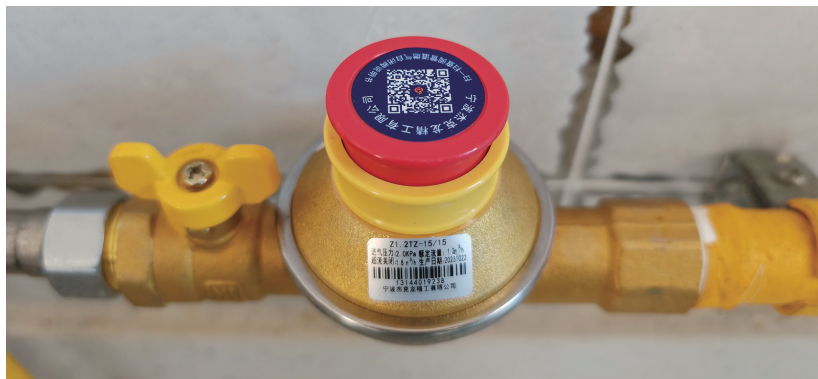
安装好的燃气自闭阀。
