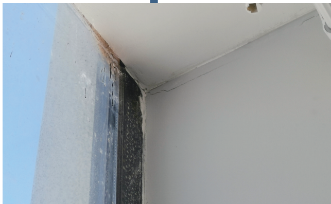
出现裂缝的墙面。
