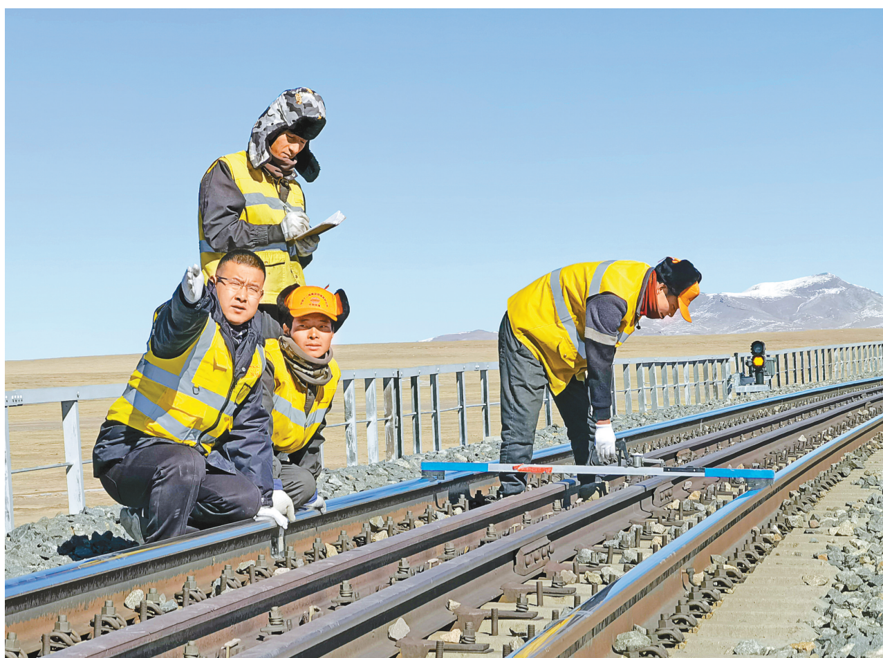
图为高钱胜(左一)和他的团队在青藏铁路多年冻土区段进行路基病害整治和检查。
